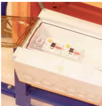
Technik-Schließfach mit Sicherungskasten
